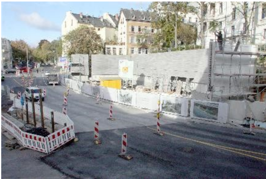
Langsam nimmt die Gedenkstätte am Michelsberg Formen an: Im Boden gibt heller Naturstein die Umrisse der 1938 abgebrannten Synagoge wieder, vorne links sieht man die Stahlträger, die die südöstliche Ecke der Synagoge markieren. Foto: RMB/Kubenka
